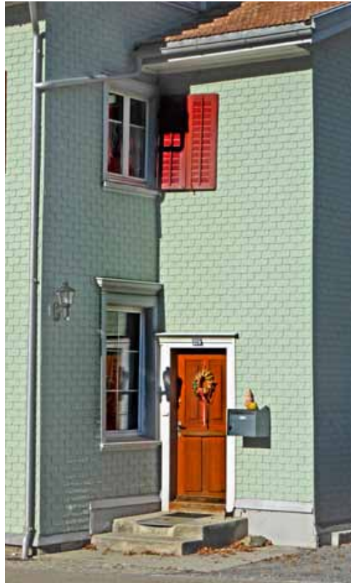
Abb. 100 Links: Der Platz ist derart knapp, so dass sich die Abwürfe über den Fenstern fast berühren. Wie im EG wäre herunziehen eine Option gewesen. Heiden
