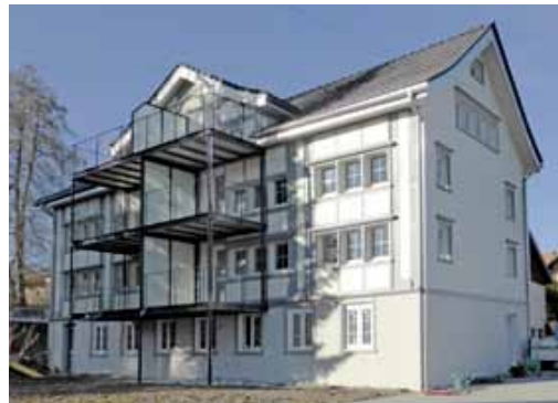
Abb. 69 Ein sehr sorgfältig renoviertes Haus, bei dem die typischen Elemente erhalten blieben. Die Ergänzung mit einem Stahl-Balkongerüst zerstört allerdings die guten Proportionen. Speicher.
