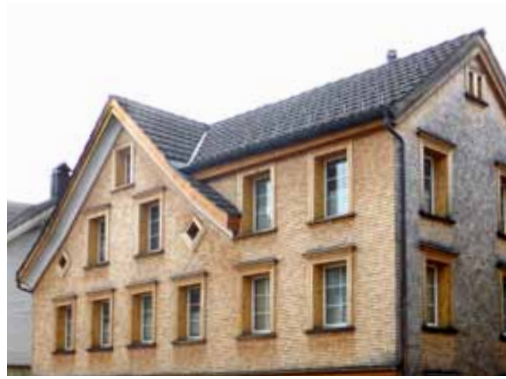
Abb. 99 Hier wurde wohl der Anbau um ein Stockwerk erhöht, und hat so eine groteske Situation in der Fassade entstehen lassen. Das Dach wächst fast aus der Fensterlaibung. Stein.
