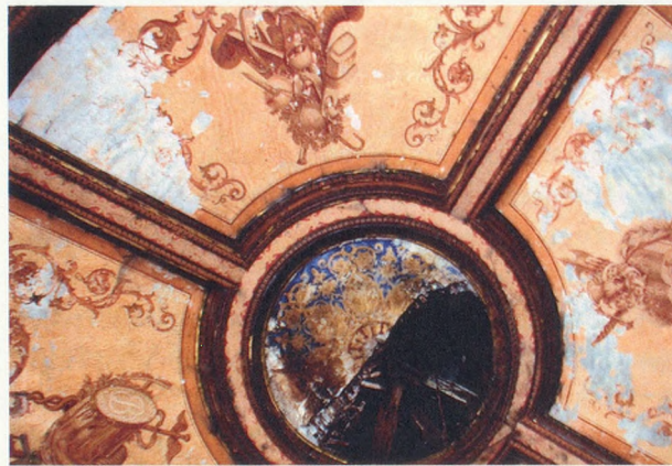
Deckenausschnitt mit Bauschäden.
