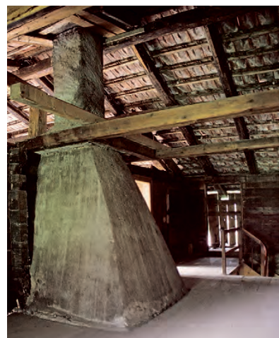
Einfaches Rafendach in einem (abgebrochenen) Bauernhaus von 1591 in Vilters. Aus dem Obergeschoss sieht man direkt ins Dach, im Vordergrund der Rauchfang einer Herdstelle. Foto: Kantonale Denkmalpflege St. Gallen.
