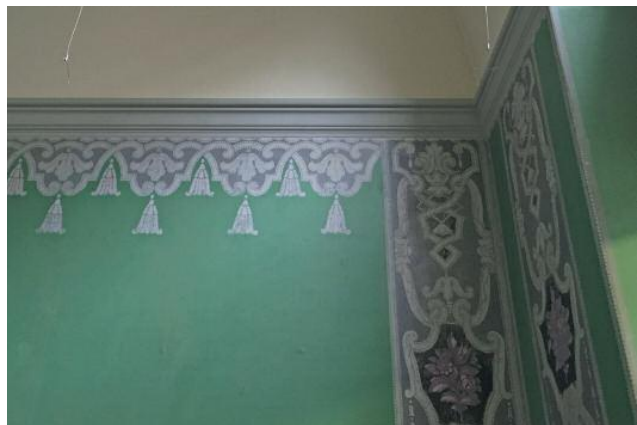
An wenigen Stellen sind noch Bruchstücke der originalen Ausmalung erhalten. Diese wurden konserviert und sorgfältig abgedeckt. Heute befindet sich die Küche eines Schnellimbiss-Restaurants in diesem Raum.
