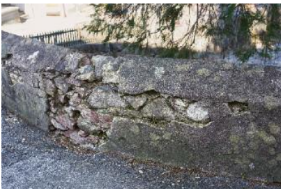
Putzschäden am Zementmörtel.
