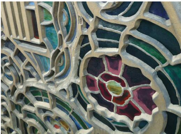
Das Schadensbild der Kunstverglasung war vielfältig: Risse und Abplatzungen im Beton, gesprungene oder teilweise fehlende Gläser und mangelhafte Reparaturen früherer Renovationen. Aufnahme vor der Restaurierung (2014).
